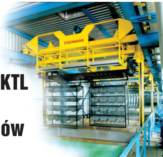
Fot. 1. Linia KTL z 15 wannami: lakierowanie elementów z metalu do samochodów osobowych i ciężarowych, m. in. marki Porsche Cayenne lub Mercedes-Benz Unimog
