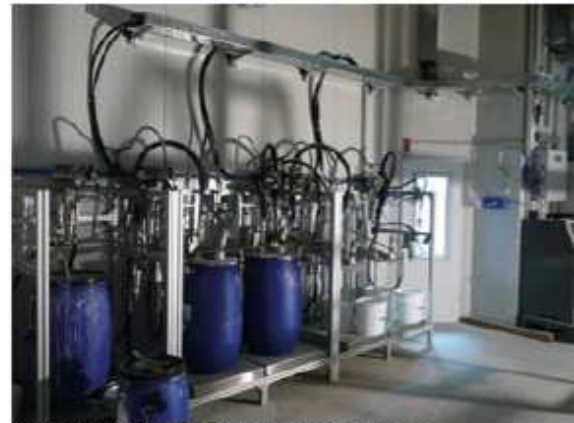
Stacja zasilania lakierami dla 4 kolorów i środka pitującego.
